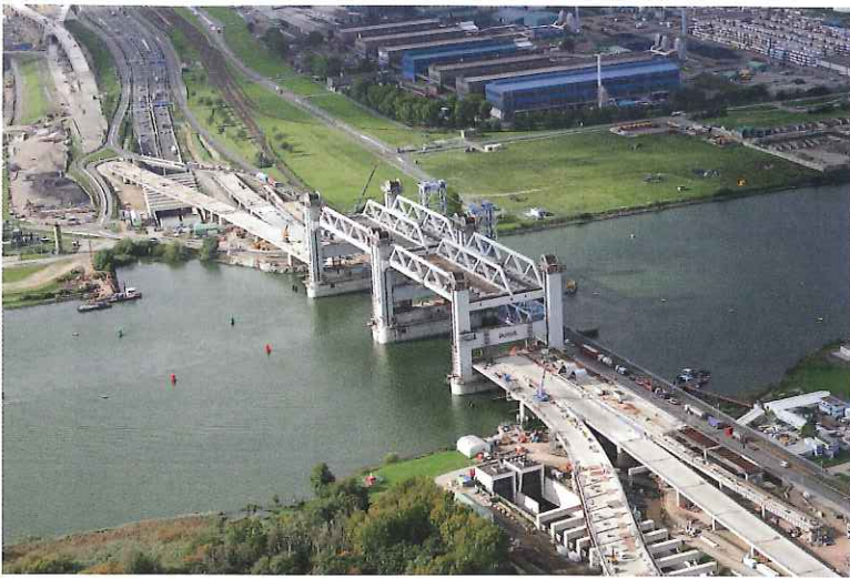
■ Brücke im gehobenen Zustand während des Baus © VCE Vienna Consulting Engineers ZT GmbH
